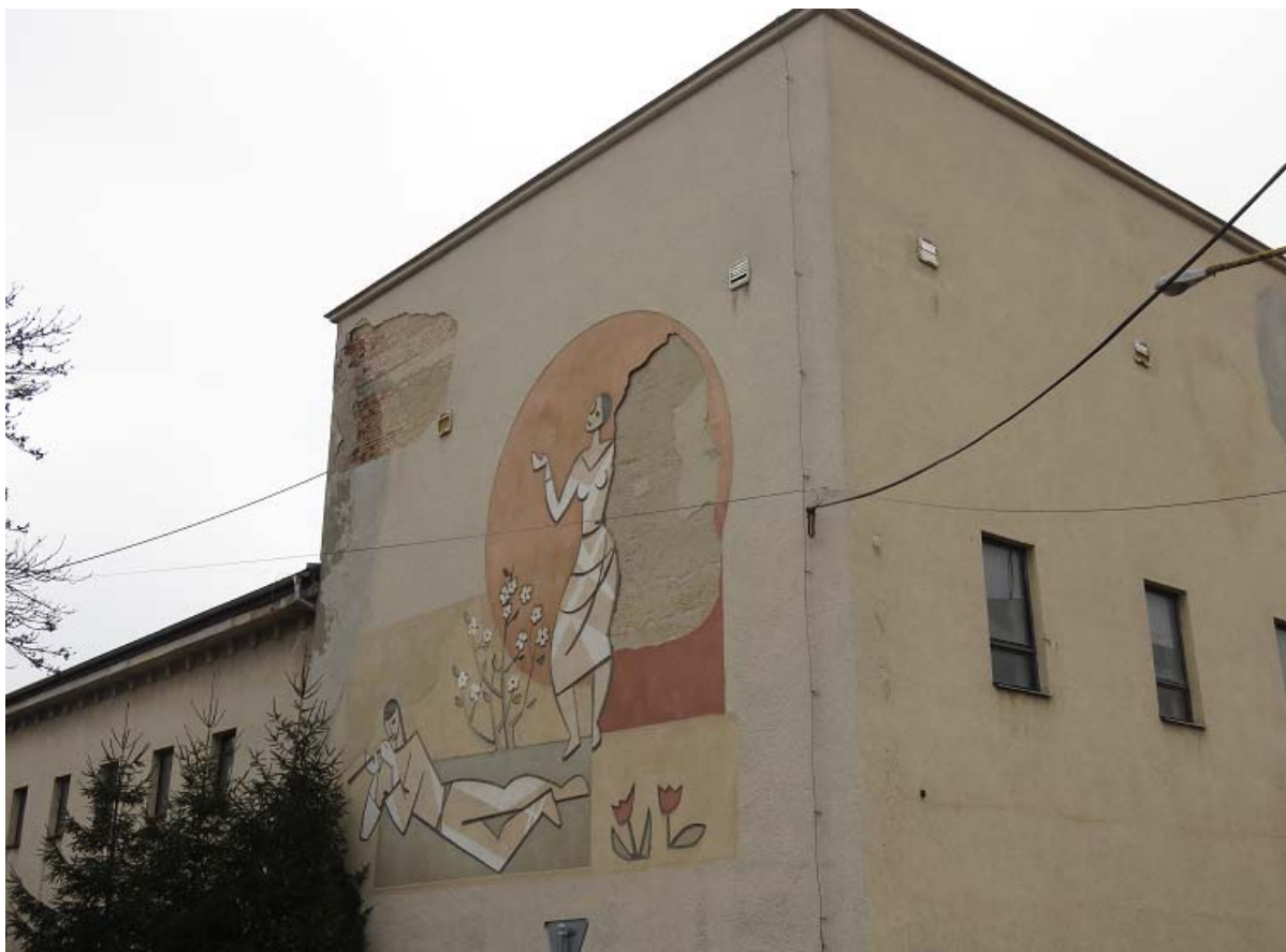
Budova bývalého KaSS – poškodená fasáda a umelecké dielo
