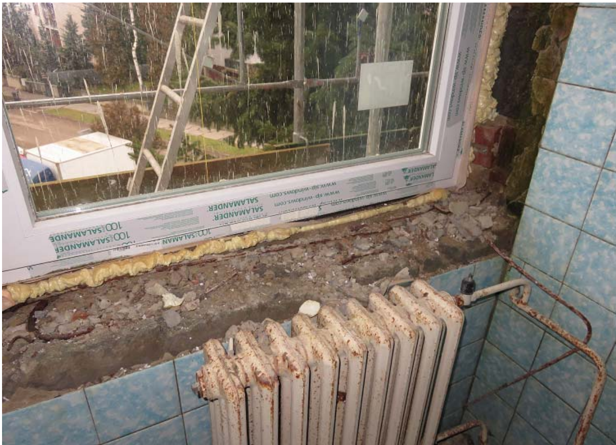
Budova plavárne – montáž okien do nevyspravených, vlhkých a plesnivých okenných otvorov
