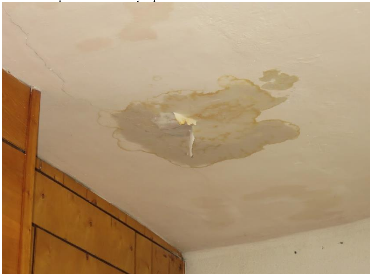
Budova OÚ – poškodenia vnútorných priestorov
