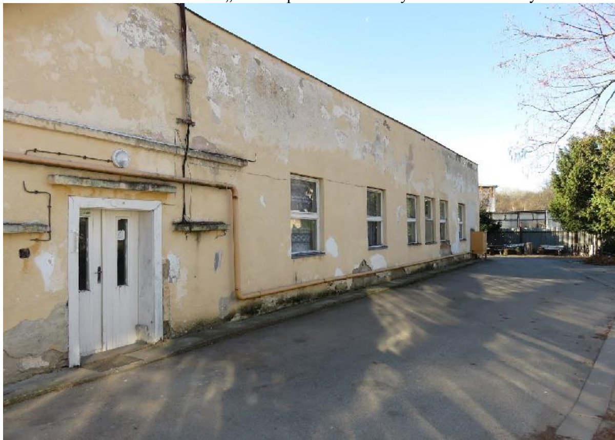
Administratívna budova MsHS – „stará“ – poškodenia fasády a zatekanie strechy
