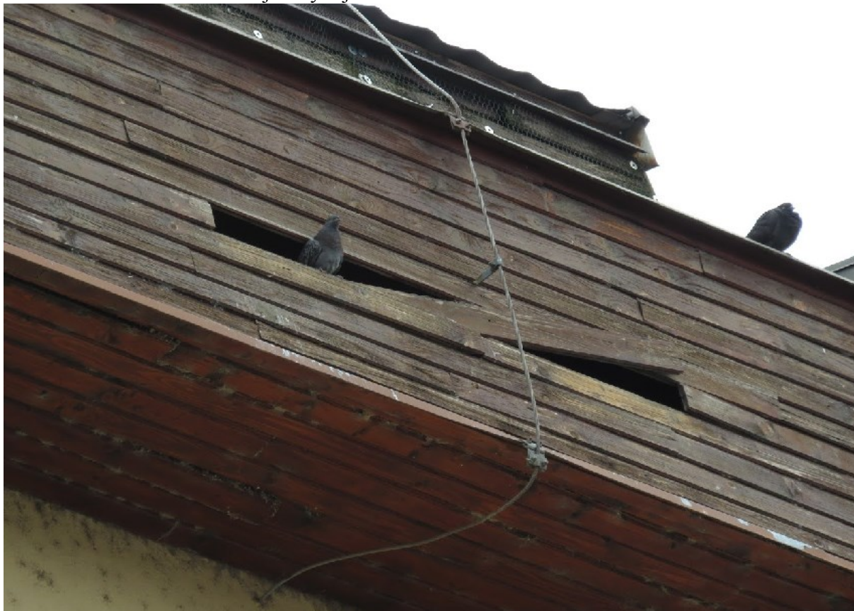
Poškodené obloženie strešnej atiky – južná strana
