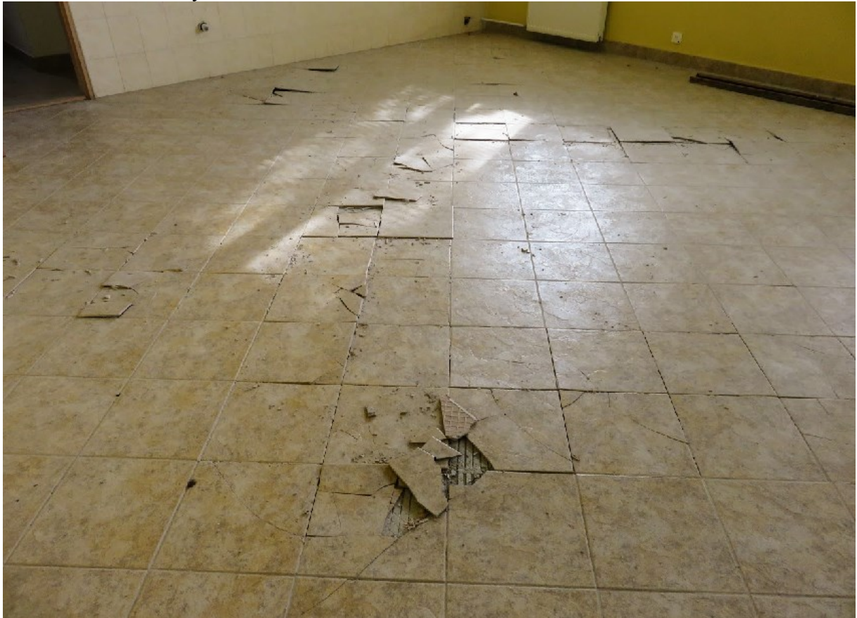
Uvoľnená dlažba – bývala reštaurácia
