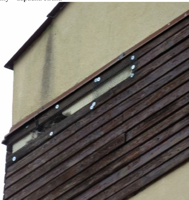
Poškodené obloženie strešnej atiky – západná strana
