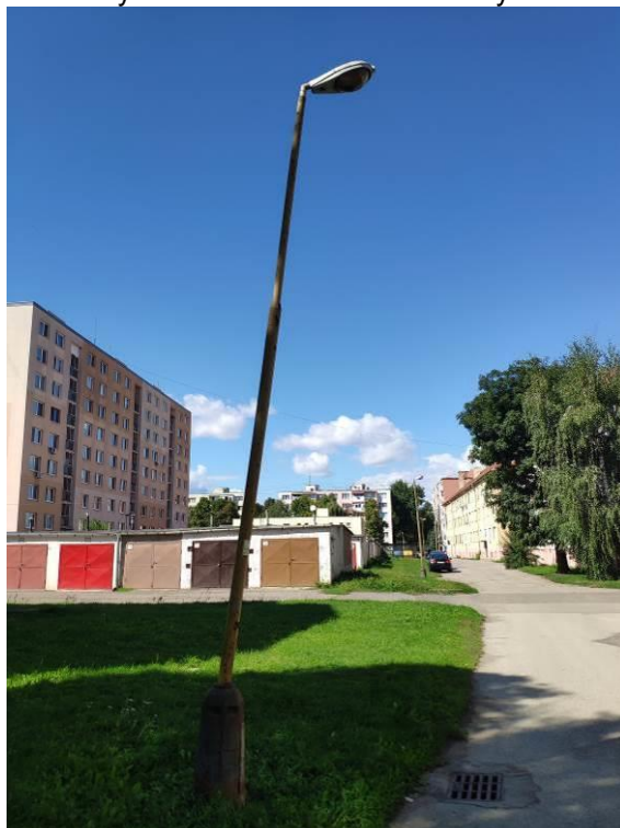
Obr. 9 Skorodovaný stožiar a narušená statika stožiara
