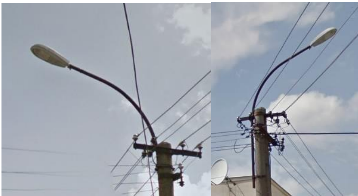
Obr. 6 Skorodovaný, nepevný výložník
