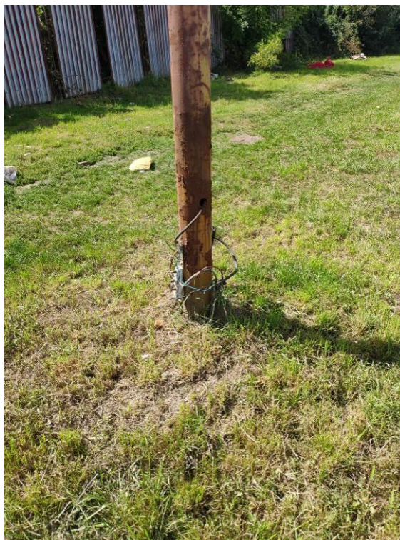
Obr. 12 Chýbajúca laminatová päťka stožiara – odkryté živé časti pod napätím
