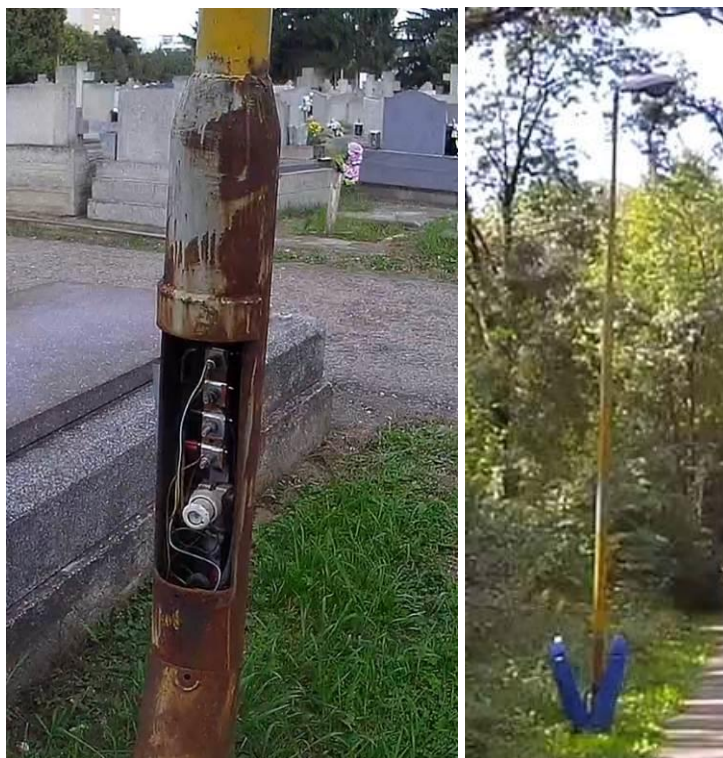
Obr. 10 Skorodovaný stožiar a otvorená svorkovnica stožiara so živými časťami
