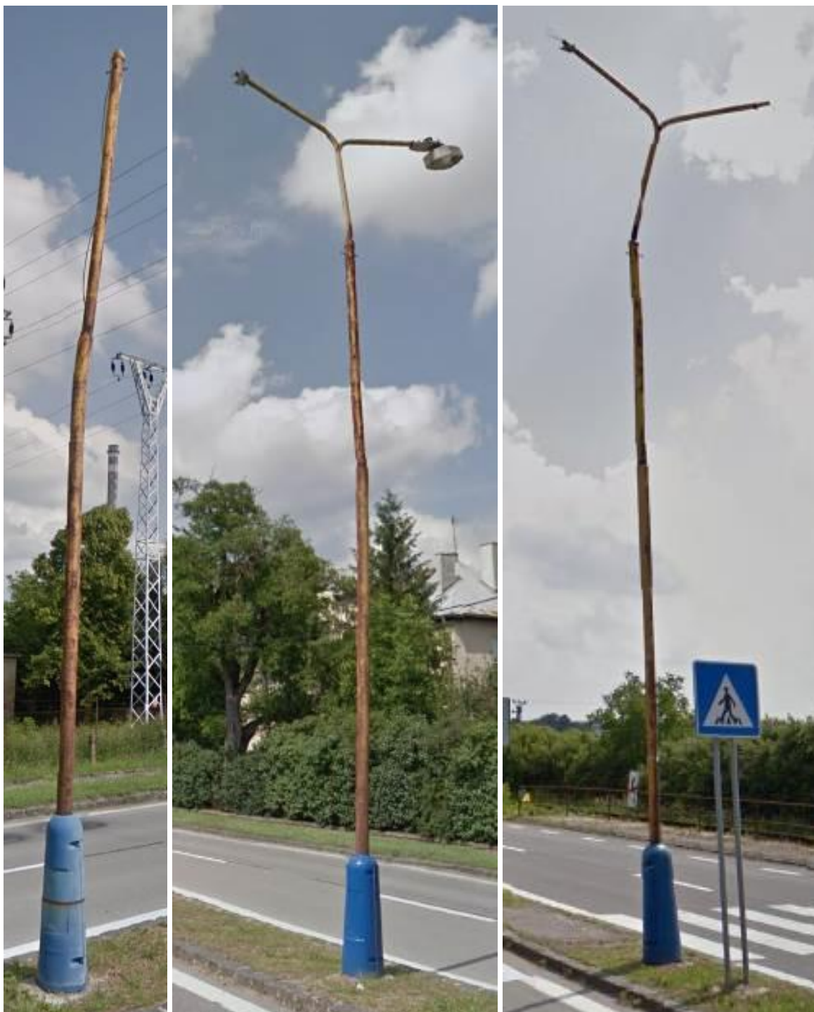
Obr. 7 Skorodovaný stožiar bez svietidla (výložníka), narušená statika
