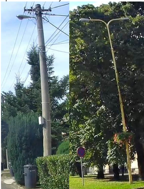
Obr. 4 Svietidlá na rôznych stožiaroch Oceľový stožiar – betónový stožiar
