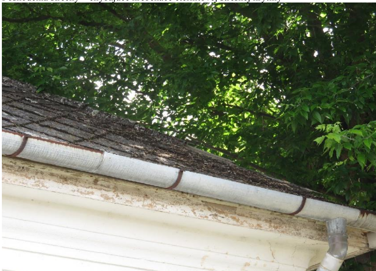
Poškodenia strechy – chýbajúce hrebenáče eternitovej strešnej krytiny
